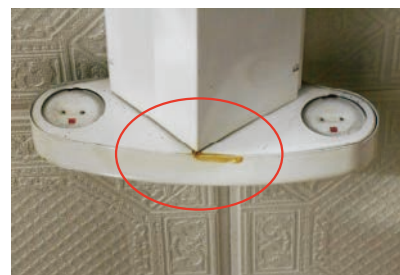
蛍光灯安定器の劣化により蛍光灯機器から PCB 油が漏れ出した例
