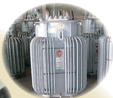
■PCB廃棄物となったトランス
