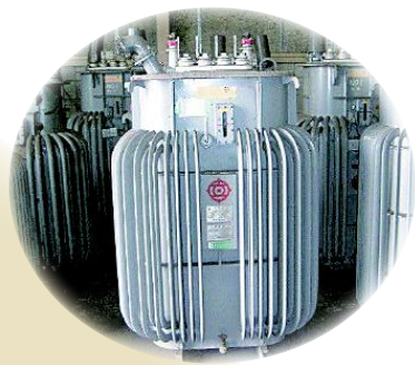
■PCB廃棄物となったトランス
