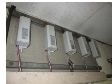
工場等の壁際に設置されている例
