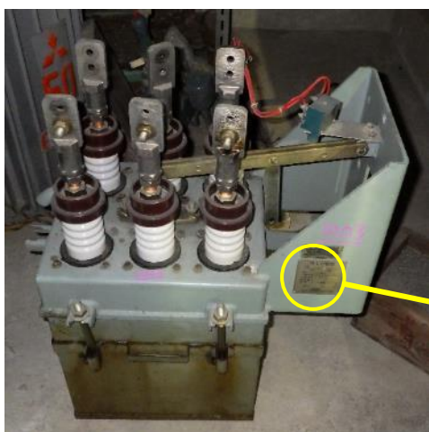
遮断器（油入遮断器）
